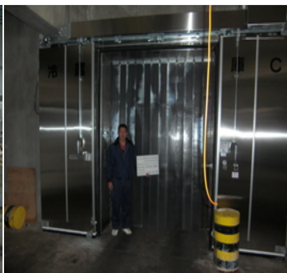
冷蔵庫扉が一新されました！！
